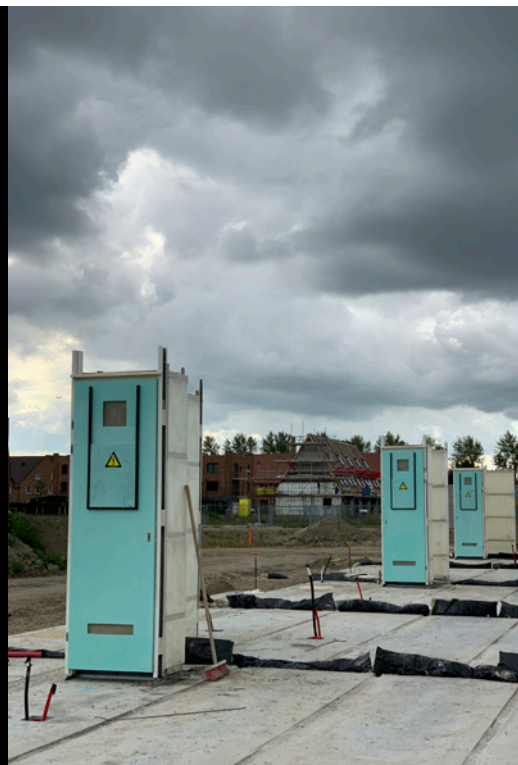
▲ De meterkast moet wind- en waterdicht worden gemaakt en beveiligd zijn tegen vandalisme en potentiële schade door bouwwerkzaamheden. (foto: Tudorpark te Hoofddorp)
